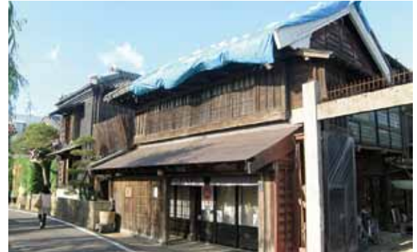
写真16 千葉県香取市佐原 土蔵造り町家の屋根瓦崩落[15・16 撮影:山崎鯛介]
