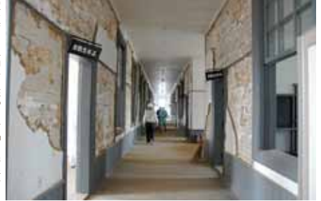
写真8 福島県郡山市「旧安積中 学校本館」内壁の剥落 [7・8 撮影:大山亜紀子]
