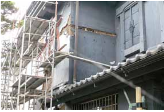
写真13 栃木県大田原市 土蔵造り建物の外壁部分破壊
