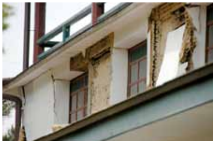
写真7 福島県郡山市「開成館」 土壁の部分破壊
