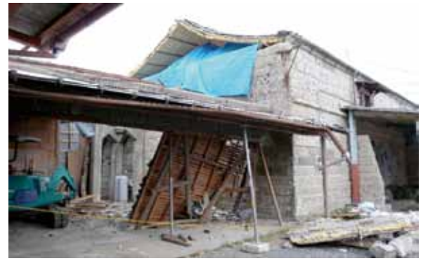
写真14 栃木県真岡市 大谷石蔵の妻壁崩落[13・14 撮影:上野勝久]
