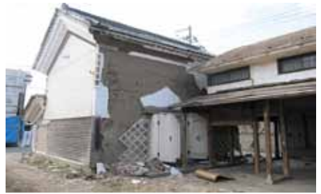
写真6 宮城県柴田郡村田町 土蔵の外壁崩落 [撮影:永井康雄]
