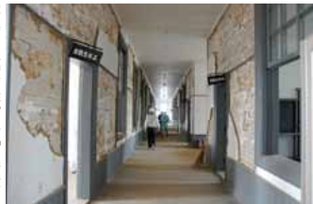
写真8 福島県郡山市「旧安積中 学校本館」内壁の剥落 [7・8 撮影:大山亜紀子]
