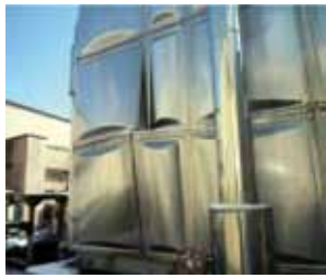
写真1 破損した高架水槽 [提供:A病院]
