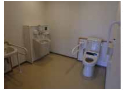
写真6 車いす対応トイレ(事例1)
