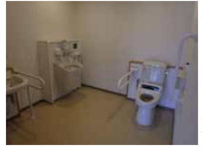
写真6 車いす対応トイレ(事例1)
